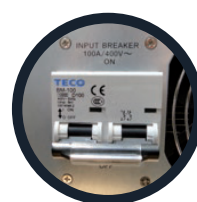
Breaker de entrada
